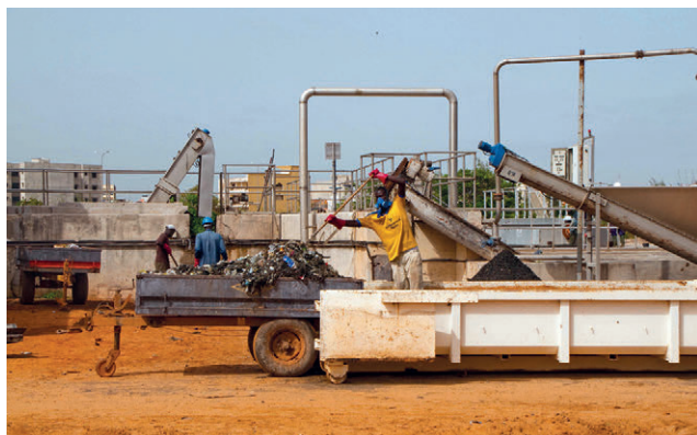
Figure 11.1 : Un ouvrier de maintenance nettoie les dégrilleurs mécaniques ; cette activité essentielle doit être réalisée à chaque dépotage pour assurer le fonctionnement du système. Dakar, Sénégal (photo : Linda Strande).
