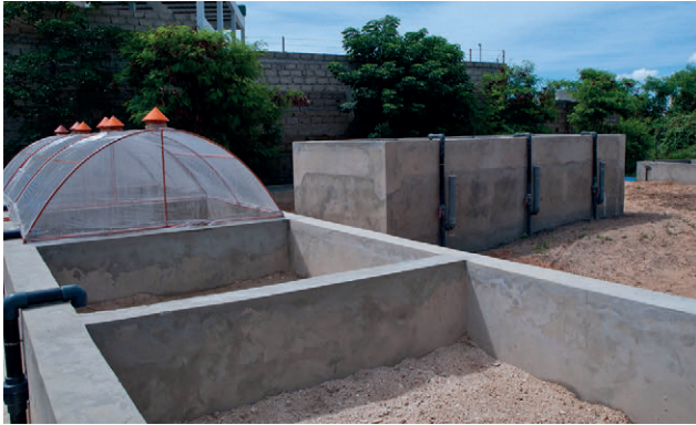
Figure 7.7 : Installation pilote à la station de traitement de Cambérène, Dakar, Sénégal, pour évaluer la déshydratation possible avec ventilation passive et active, sous serre (photo : Linda Strande).
