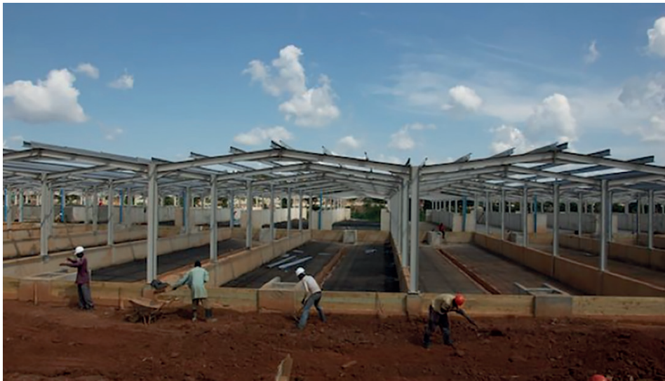
Figure 18.1 : Lits de séchage pour le traitement des boues de vidange en cours de construction sur le site de Lubigi à Kampala. Étape 1 du projet de protection du lac Victoria financé par la KFW, l'UE et le gouvernement ougandais (NWSC) (photo : Lars Schoebitz).
