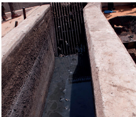
Figure 8.5 : Réservoir de stockage et de mélange utilisé au Sénégal, avec un dégrillage pour éviter le colmatage des lits par des ordures (photo : Linda Strande).
