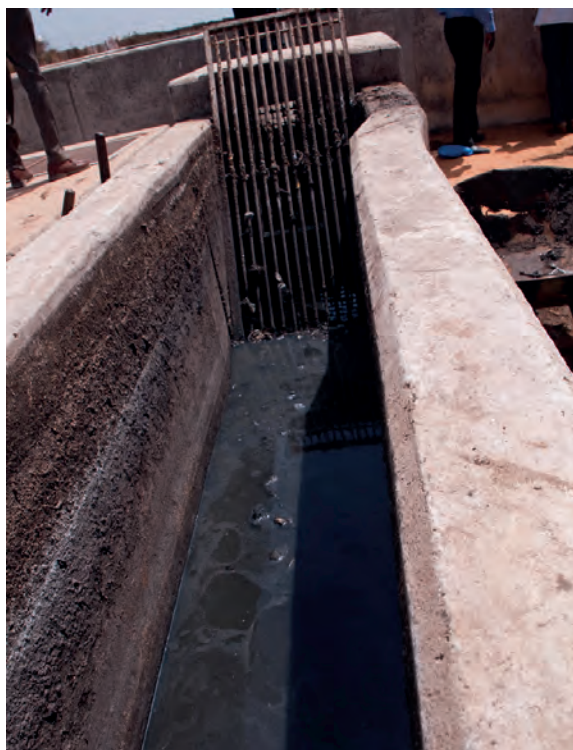
Figura 8.5 Tanque de almacenamiento y mezclado en Senegal, con un tamiz de barras para prevenir el ingreso de basura que podría atascarse en los equipos (foto: Linda Strande).
