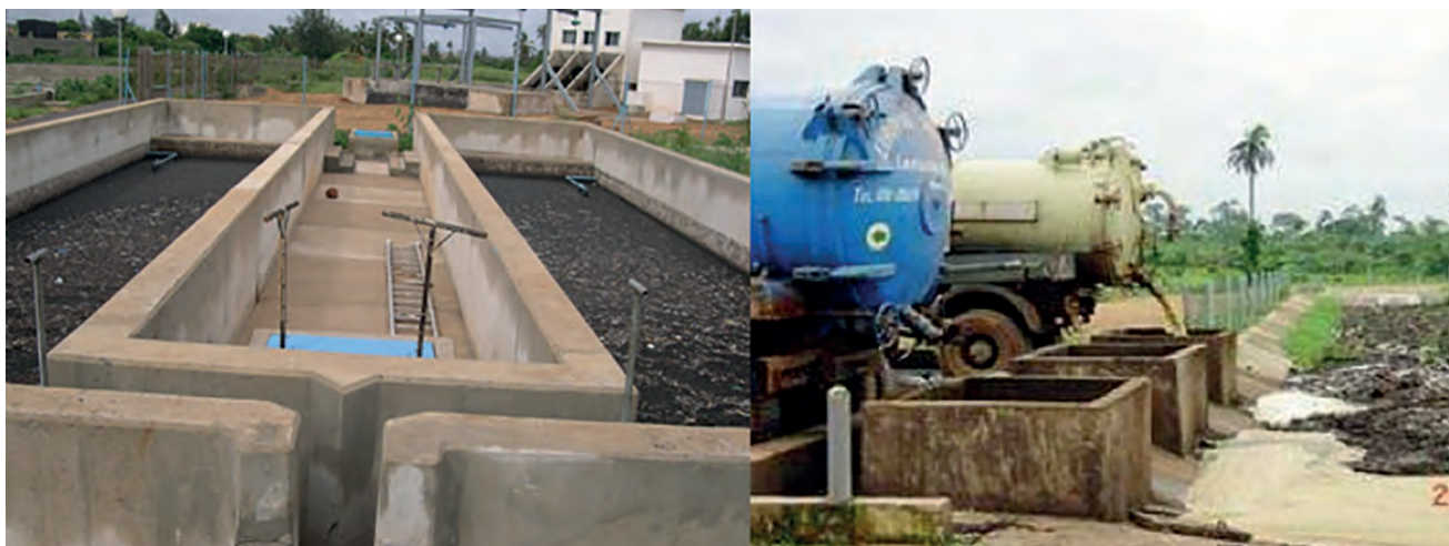
Figura 6.2 Los dos tanques de sedimentación y espesamiento de la Estación de Tratamiento de Lodos Fecales Rufisque en Dakar, Senegal (izq.). El ciclo operativo dura 2 semanas (1 semana de uso, otra de reposo) y luego se bombean los lodos a lechos de secado. La laguna de sedimentación y espesamiento en Achimota, Accra, Ghana, tiene un ciclo operativo de 8 semanas (4 semanas de uso, 4 semanas de reposo; der.). Como los lodos se espesan durante 4 veces más tiempo, no es posible extraerlos con una bomba y su retiro es manual (foto: SANDEC).
