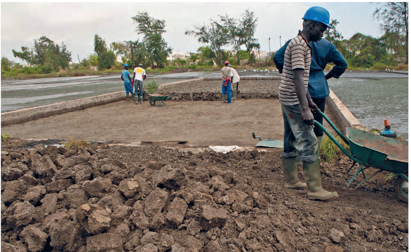
Figura 7.5 Extracción de lodos de los lechos de secado sin plantas en la Estación de Tratamiento de Lodos Fecales Cambérène, en Dakar, Senegal. En primer plano, se observan los lodos ya sacados (foto: Linda Strande).
