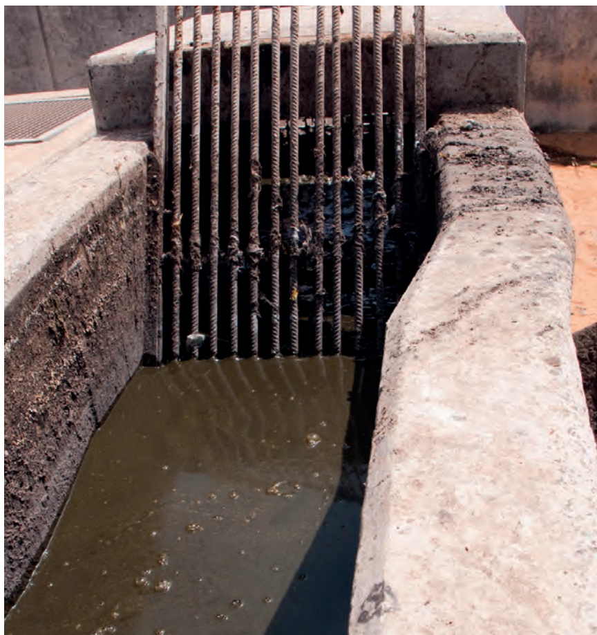
Figura 3.6 Tamiz de barras en la Estación de Tratamiento de Lodos Fecales Niayes, en Dakar, Senegal (foto: Linda Strande).
