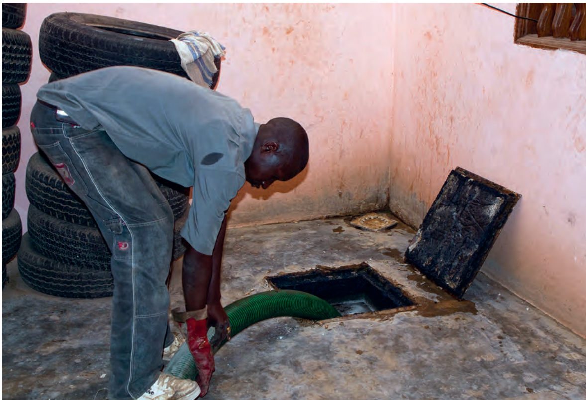
Figura 4.2 Ejemplo del vaciado de lodos fecales en Dakar, Senegal, con la estructura de contención ubicada en un patio interno donde hizo falta la cooperación de los residentes para el acceso (foto: Linda Strande).
