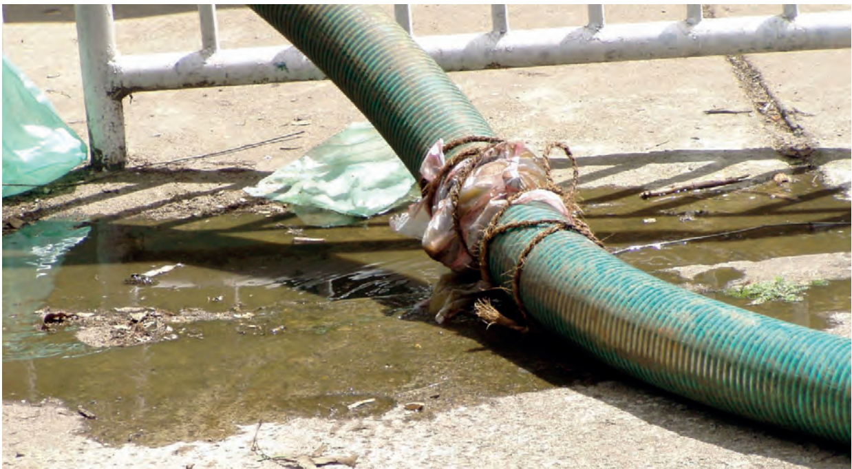
Figura 4.4 Las mangueras y sus accesorios requieren frecuente atención y reparación para mantenerles funcionando debidamente. Esta foto muestra un caso de mantenimiento inadecuado, con fugas de LF que salen de roturas en una manguera (foto: David M. Robbins).
