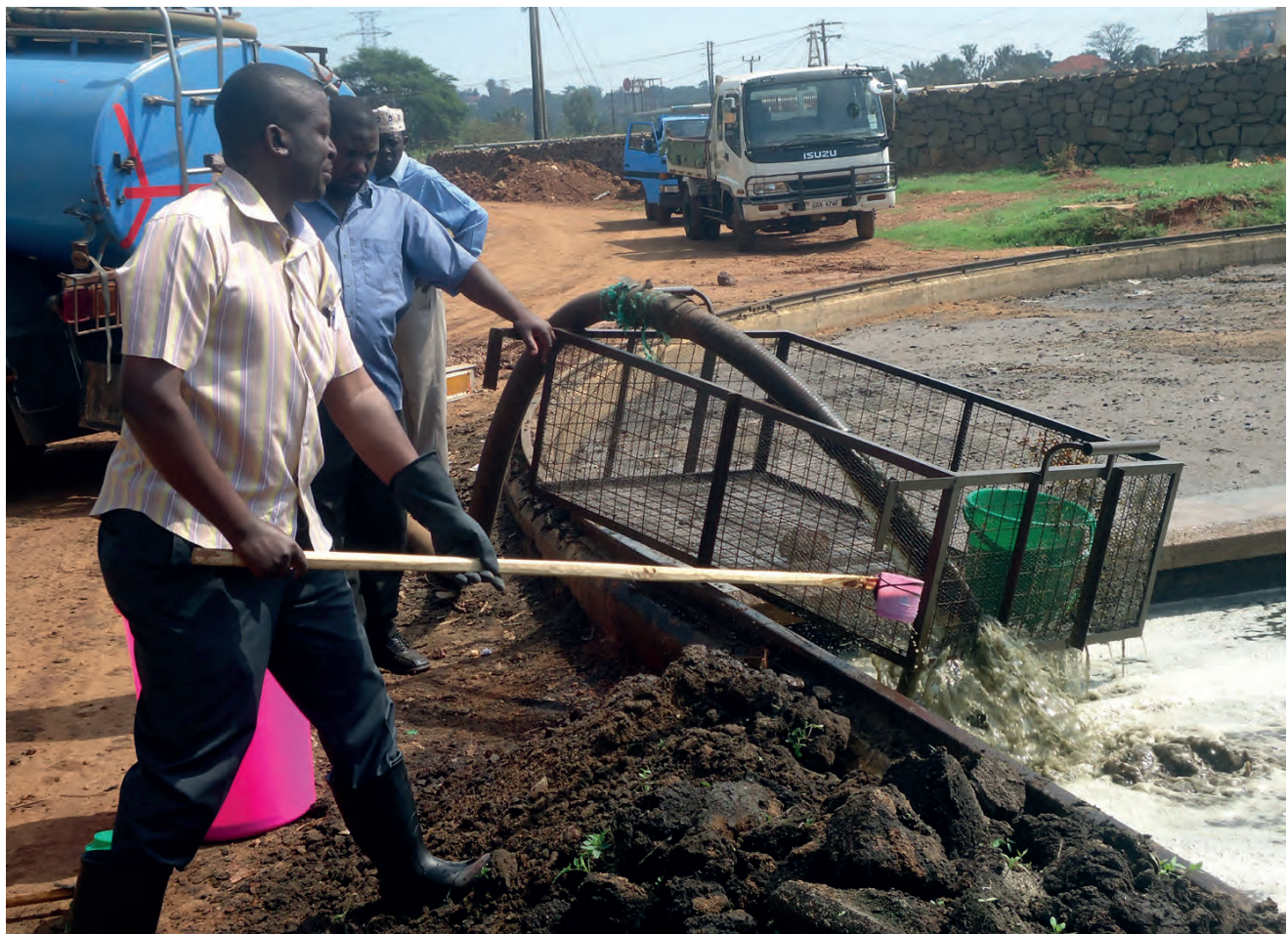
Figura 2.5 Separación de desechos sólidos de los lodos fecales mediante un tamiz de barras, en el afluente a una estación de tratamiento, durante un evento de muestreo en Kampala, Uganda (foto: Daniel Ddiba).
