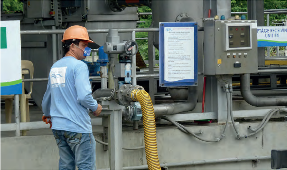
Figura 4.16 Puesto automatizado para la recepción de lodos fecales en la Estación Sur de Tratamiento de Lodos de Tanques Sépticos, operado por el Departamento de Agua de Manila, Filipinas (foto: WSUP, Sam Parker).
