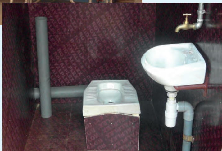
Figura 4.17 Estación de transferencia multifuncional, modular y de gran volumen (arriba) y uno de sus inodoros (abajo) (foto: GOAL).
