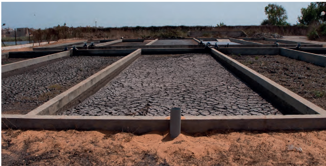
Figura 3.4 Lechos de secado sin plantas en la Estación de Tratamiento de Lodos Fecales Niayes, en Dakar, Senegal (foto: Linda Strande).
