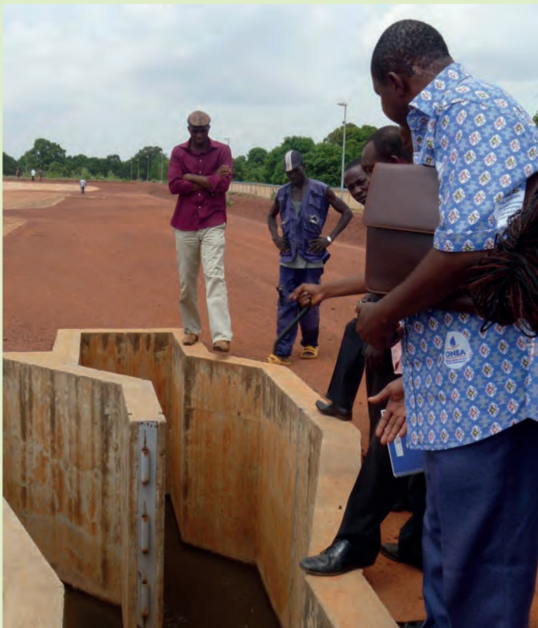
Figura 16.8 Los actores inspeccionan el punto de entrada de los lodos en una nueva estación de tratamiento de lodos fecales en Burkina Faso (foto: Magalie Bassan).
