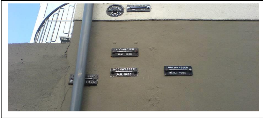
Abbildung 3: Wasserstandsmarken an einem Wohnhaus am Rheinufer von Urmitz (bei Koblenz) [Aufnahme Sept. 2008]. Die runde Marke (oben Mitte) erinnert an das extreme Hochwasser von 1882
