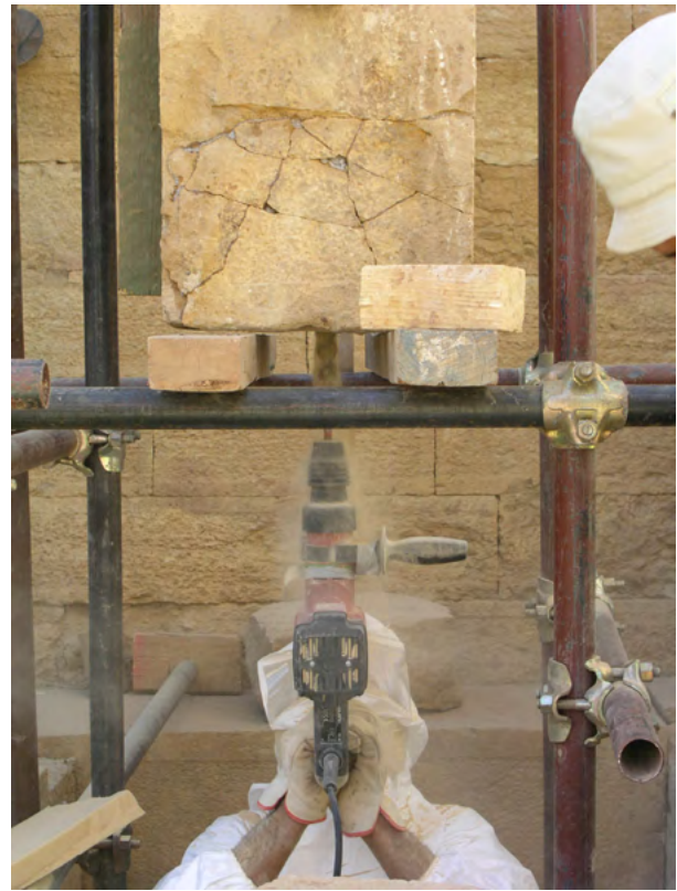
Figure 39. Fase di perforazione al centro della faccia inferiore del pilastro P12, per l'inserimento della barra d'acciaio fissata nella base artificiale del P12 (v. fig. 38). (A. Paladino 2003 ©MAIRY)
