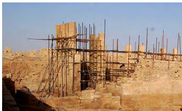
Figure 32. Vista laterale (da NO) del tempio di 'Athtar dhu-Qabḏ a fine lavori: tutte le strutture sono legate tra loro e assicurate ad una solida impalcatura di tubi metallici. (S.B. Scigliano 2006 ©MAIRY)
