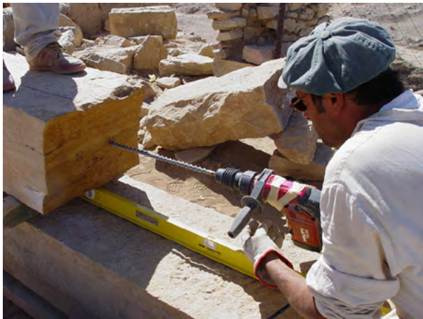
Figure 64. Fase di perforazione per l'inserimento di due barre d'acciaio per la riadesione dei due frammenti della trave principale posta sopra i due pilastri P6 e P10 e sopra il muro O della cella. (A. Paladino 2003 ©MAIRY)
