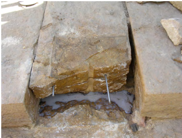
Figure 20. Tra le sezioni di contatto della base di appoggio fratturata del pilastro P11 sono state inserite, in orizzontale, due barre in acciaio inox. (A. Paladino 2003 ©MAIRY)
