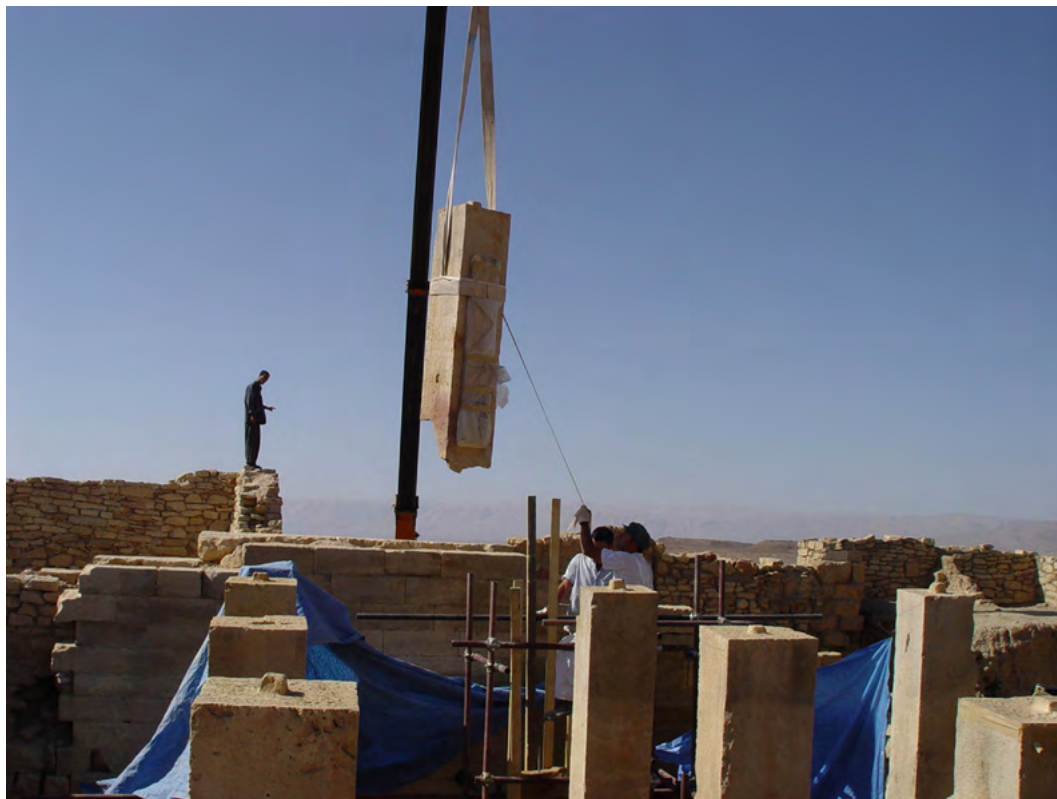
Figure 26. Rimozione del pilastro P5 con l'ausilio della gru, e collocato fuori dal tempio per il restauro. (A. Paladino 2003 ©MAIRY)
