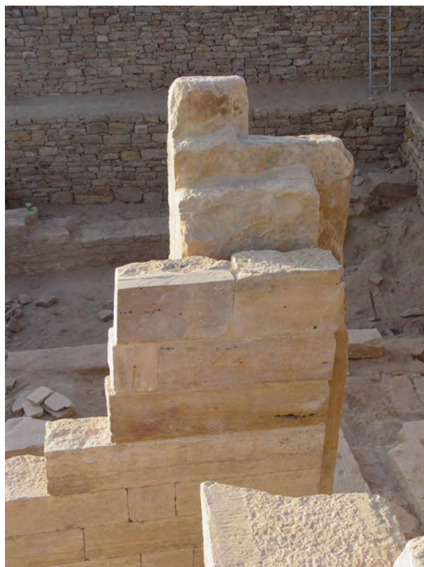
Figure 48. Dettaglio della porzione superiore dello stipite orientale della porta del tempio: sono visibili le stuccature effettuate con malta idraulica con lo scopo di sigillare e proteggere il materiale lapideo da infiltrazioni dell'acqua. (S.B. Scigliano 2003 ©MAIRY)
