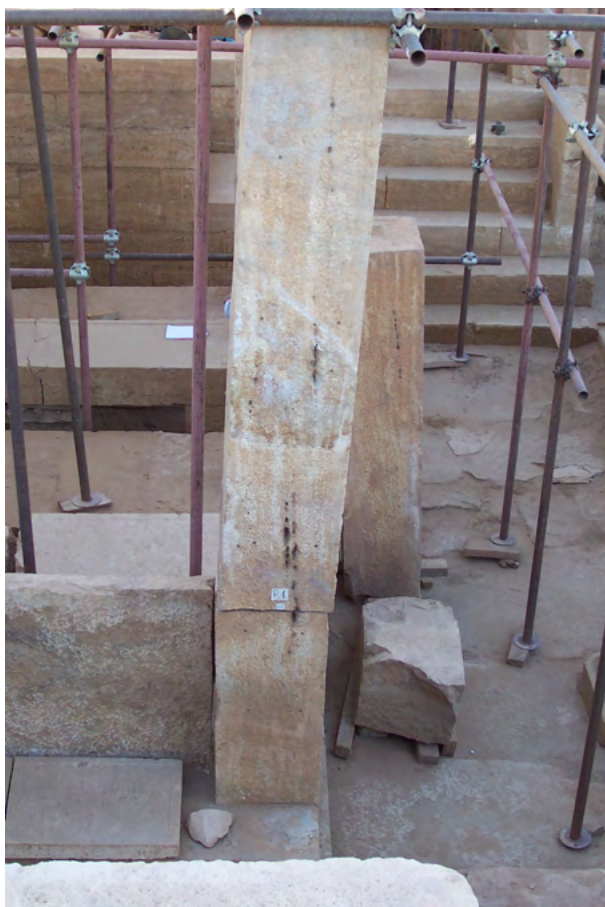
Figure 18. Il pilastro P1, inglobato per tre lati nella banchina, è completo ma spezzato e inclinato verso N. (S.B. Scigliano 2006 ©MAIRY)
