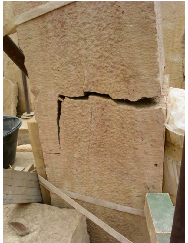
Figure 8. Il pilastro P7 con duplice frattura, orizzontale e verticale. (A. Paladino 2003 ©MAIRY)
