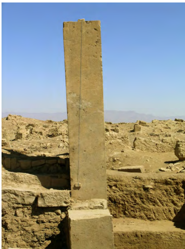
Figure 11. La pendenza dei pilastri del propileo ha provocato una inclinazione del baricentro verticale oltre la soglia di equilibrio statico. (S.B. Scigliano 2006 ©MAIRY)
