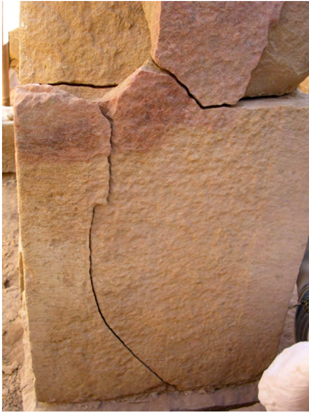
Figure 16. Frattura orizzontale con distacco totale, a circa 50 cm dalla base, del pilastro P11. (A. Paladino 2003 ©MAIRY)
