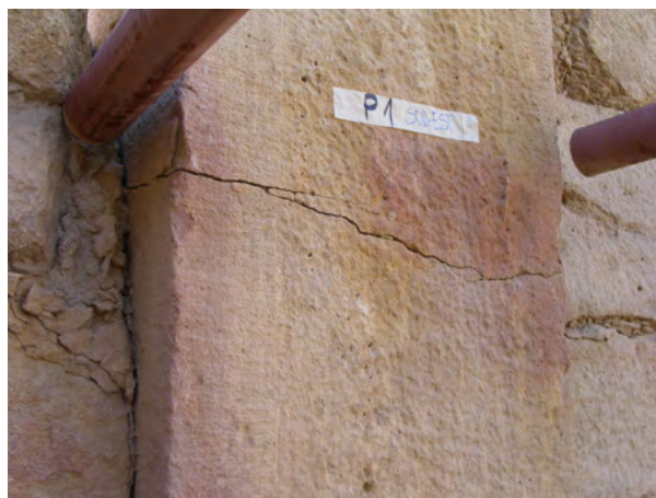
Figure 31. La frattura orizzontale con distacco del pilastro P1. (S.B. Scigliano 2003 ©MAIRY)
