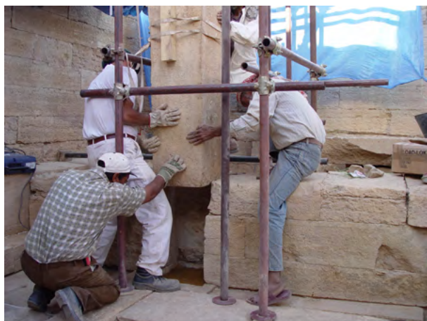
Figure 29. Ricollocamento definitivo della parte inferiore del P5 nel sedile in muratura. (A. Paladino 2003 ©MAIRY).
