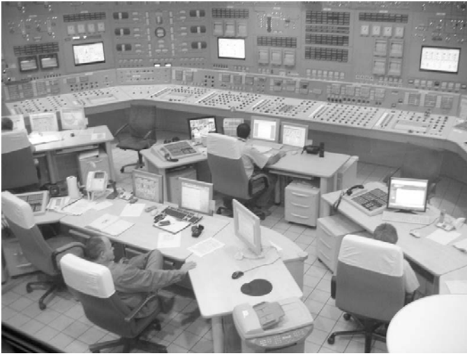
Abbildung 13: Kontrollraum des Kernkraftwerkes Paks in Ungarn.
