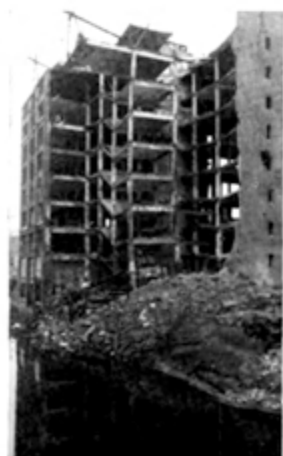
FABRIKATIONS-GESCHOSSBAU — Zerstörungsgrad ca. 75 %. Skelett- und Deckenkonstruktion und Keller teilweise erhalten.
