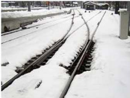
Abbildung 1: Weichenheizung, Quelle: https://de.wikipedia.org/wiki/Weichenheizung
