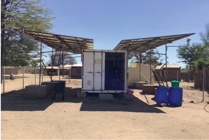
Fig. 9.3 Mthembanji solar PV mini-grid
