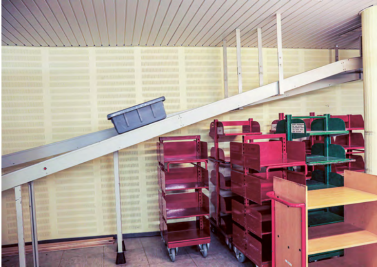
Abb. 2: Buchkastenförderanlage Staatsbibliothek Preußischer Kulturbesitz, Berlin, Potsdamer Straße, Foto 2020.
