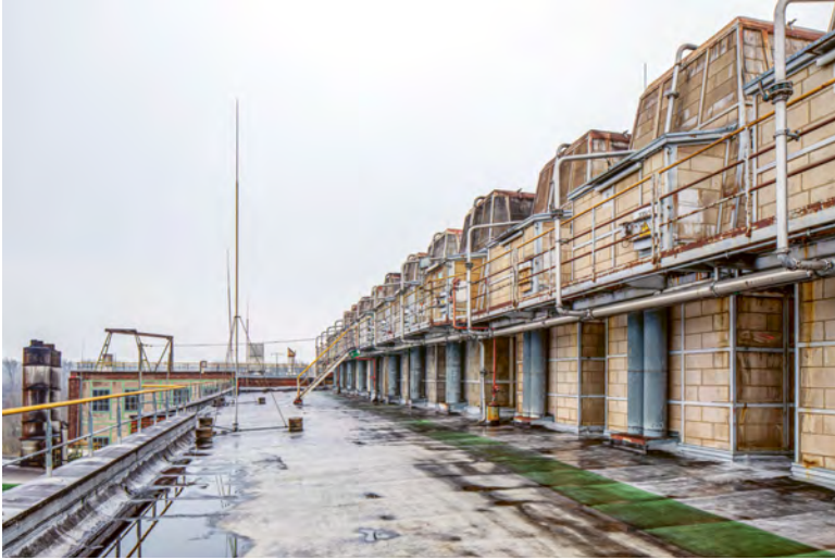
Abb. 5: Brikettfabrik Frechen-Wachtberg: Der obere Teil der Brüdenschlote auf dem Dach des Trockenhauses, Foto 2022.
