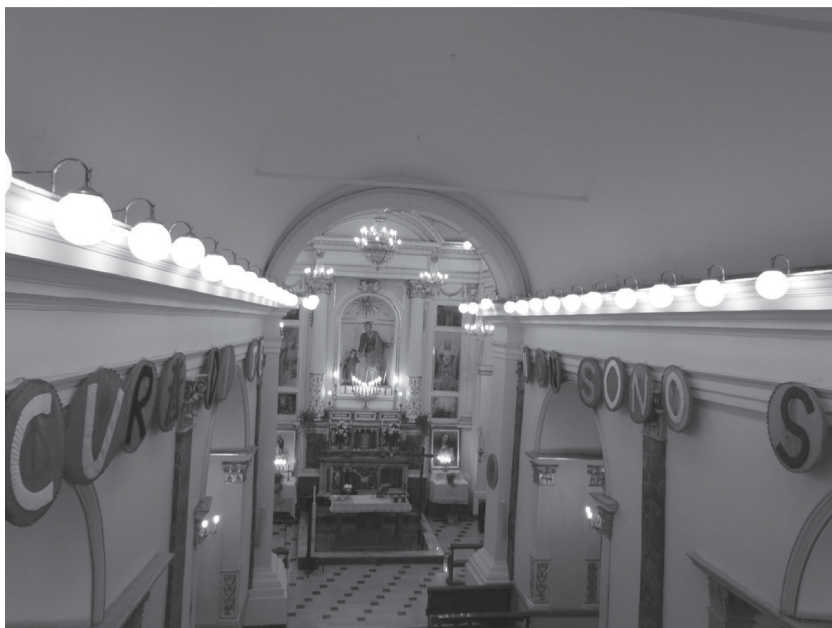
FIGURA 7 Instalación Vecchiaia Iglesia San Giuseppe Gangi, 2015
