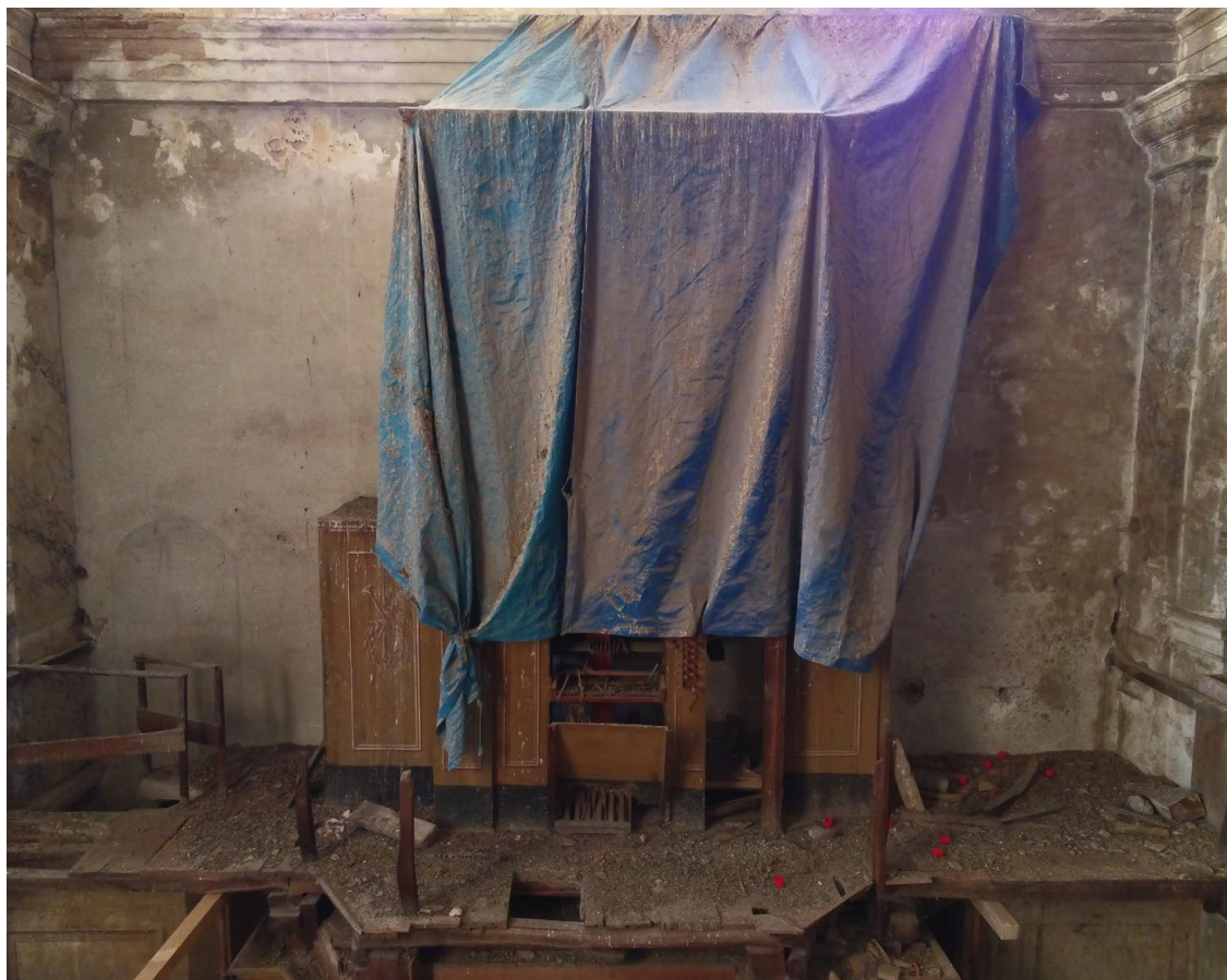
Fig. 5/ Anni 2020-2021: cantoria e organo in forte stato di dissesto e degrado. Vista acquisita durante la campagna di rilievo fotogrammetrico aereo.
